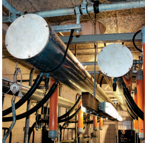
Die beiden Puffertanks wurden aufgehängt, um eine Schallübertragung zu verhindern.
