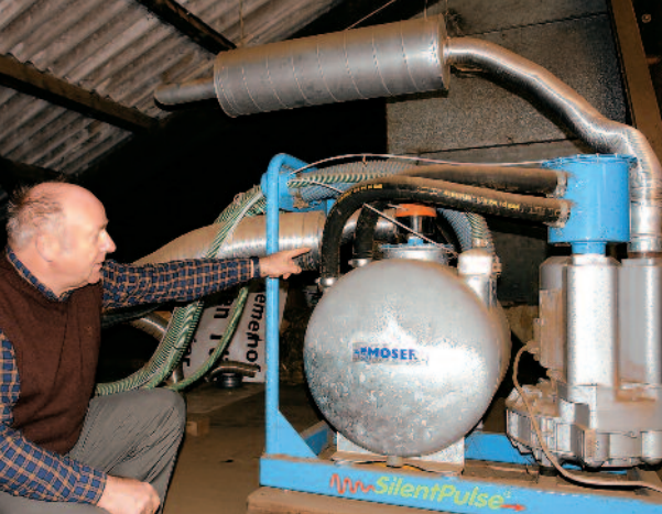
Bilgerys Vakuumpumpenaggregat ist mit einem grossen Ausgleichstank und integriertem Regelventil ausgestattet.
